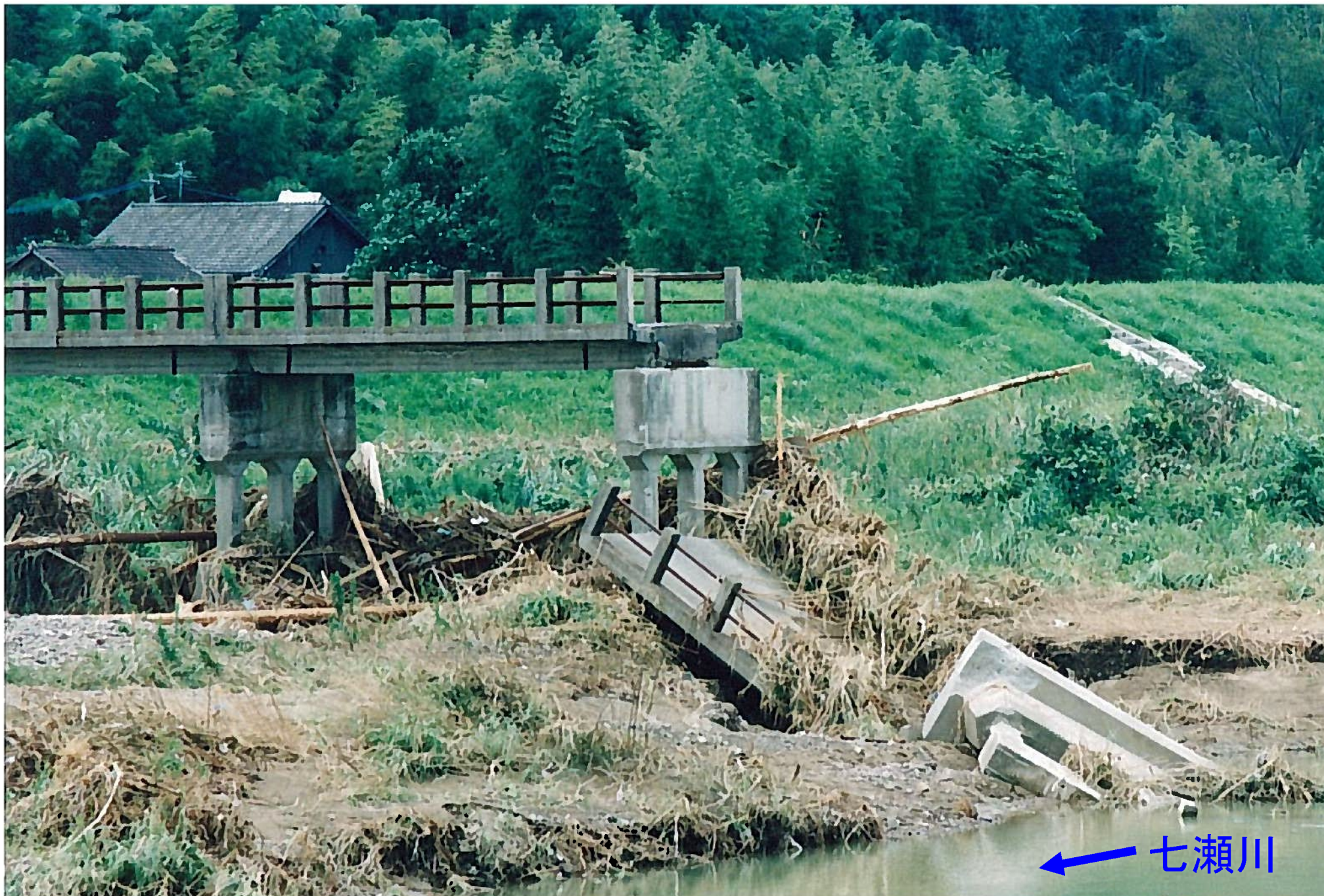
1993年(平成5年)9月洪水(台風13号) 大分川水系七瀬川 露(あらわす)橋被害状況
